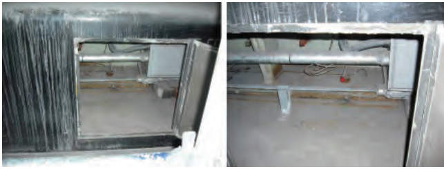
Figura 14: a) Localización de fuga en conducto termopar b) fuga reparada
