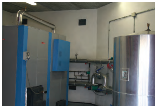
Figura 3: Central térmica instalada en el Hospital Comarcal de Zafra (Badajoz)
