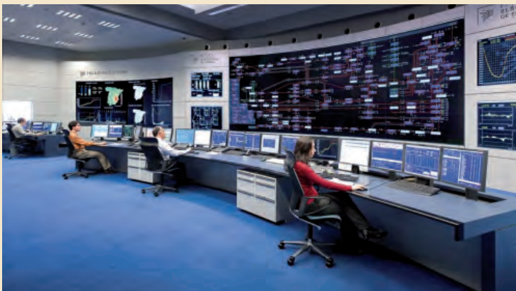
Fig. 3: Centro de Control de Régimen Especial de Red Eléctrica de España Fuente: Red Eléctrica de España
