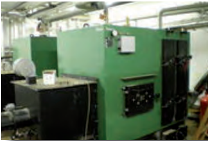
Caldera de biomasa. • Foto: DiCYT.
