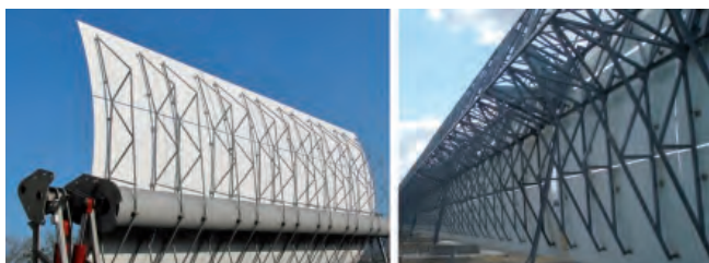
Fig. 6: Izquierda: Estructura con tubo de torsión. TERMOPOWER. Derecha: Estructura de celosía espacial.
