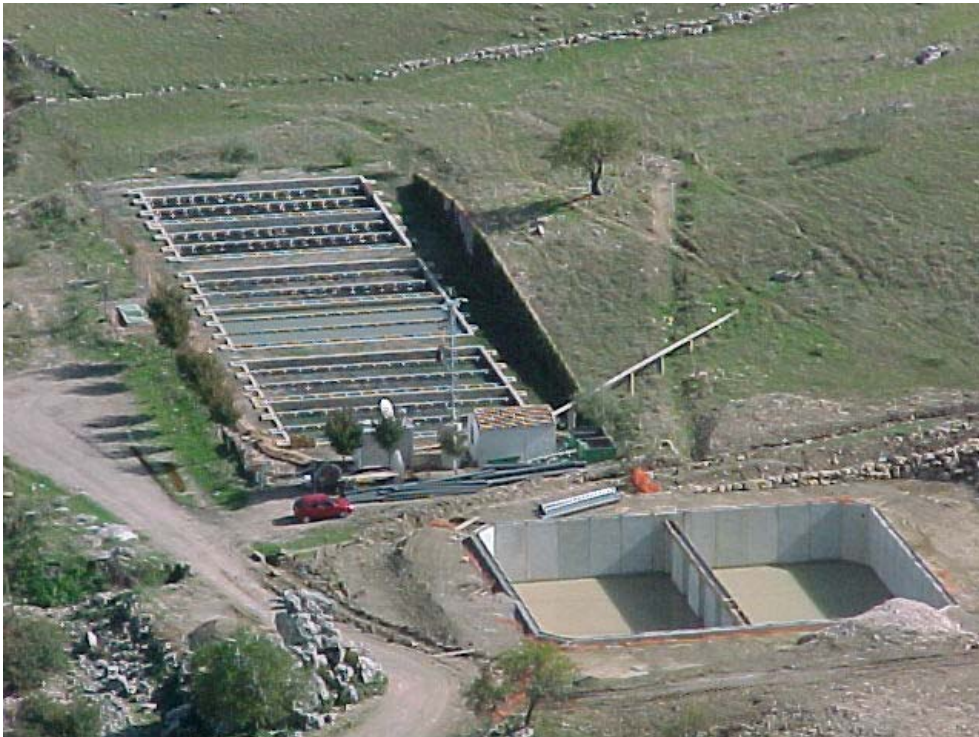
Foto 2. Vista aérea de la E.D.A.R. durante la construcción de las lagunas anaerobias
