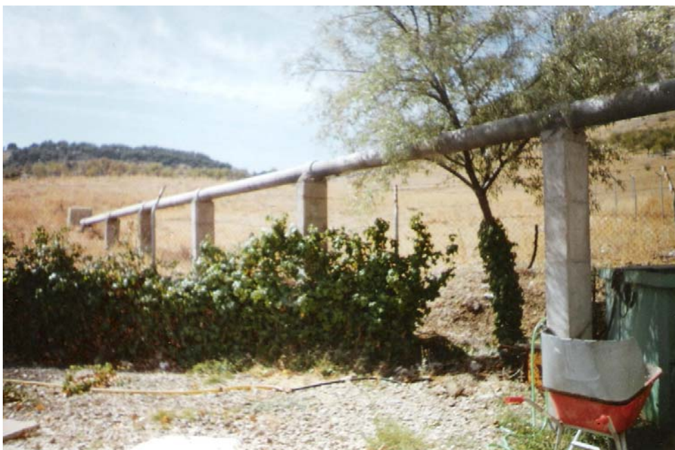
Foto 3. Tramo de entrada del colector de aguas residuales en la planta.
