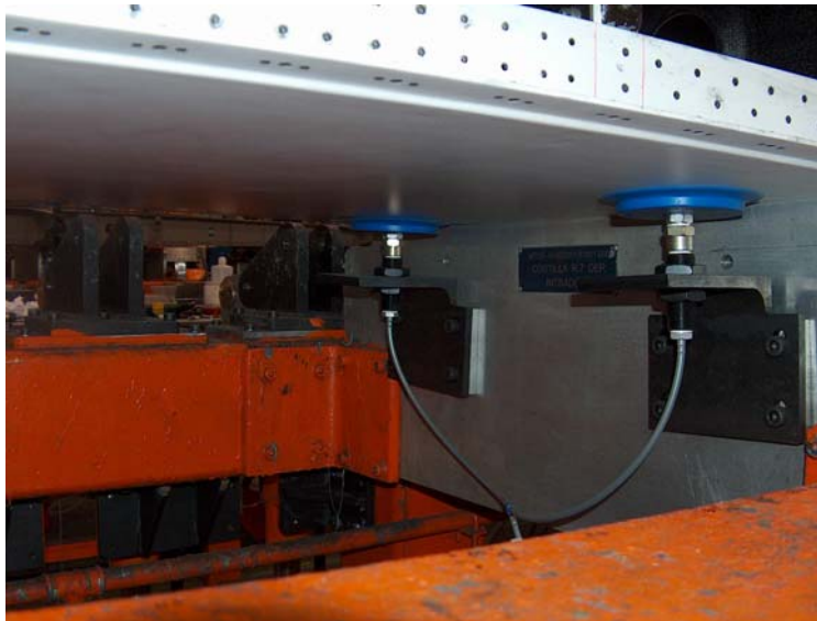
DETALLE DEL SISTEMA DE VENTOSAS, SUJETANDO EL REVESTIMIENTO INFERIOR DEL CAJÓN EN GRADA FASE II
