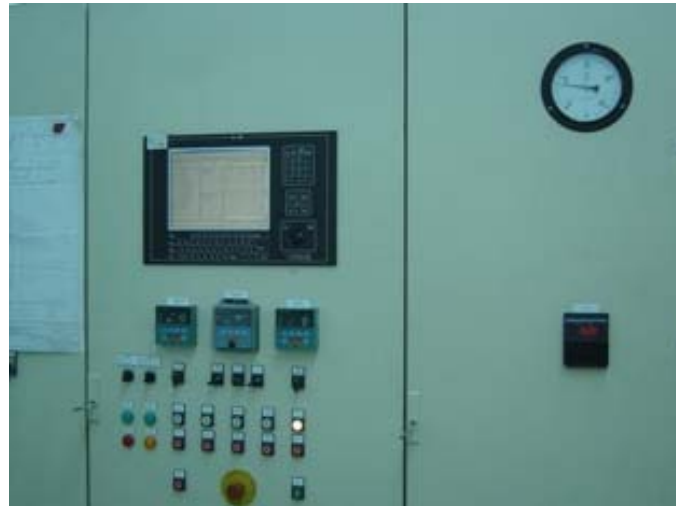
Figura 56: Computadora de control de autoclave
