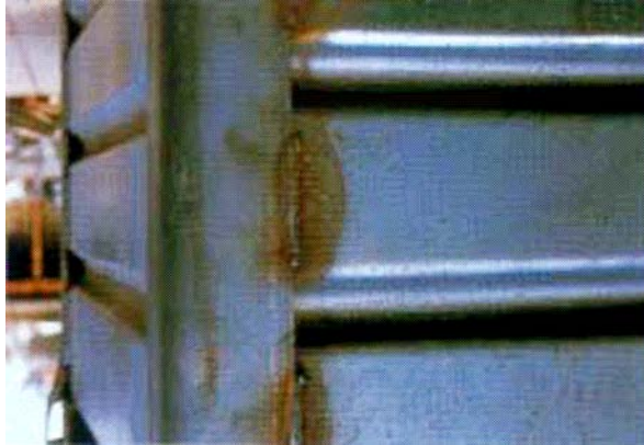
Fig. 5: Residuos de grasa quemados alrededor de una soldadura de un contenedor (antes de la galvanización) pueden producir defectos en el recubrimiento
