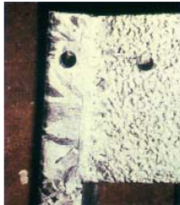
Fig. 8: Construcción fabricada en parte con material viejo. Se aprecian claramente las marcas de la herrumbre.
