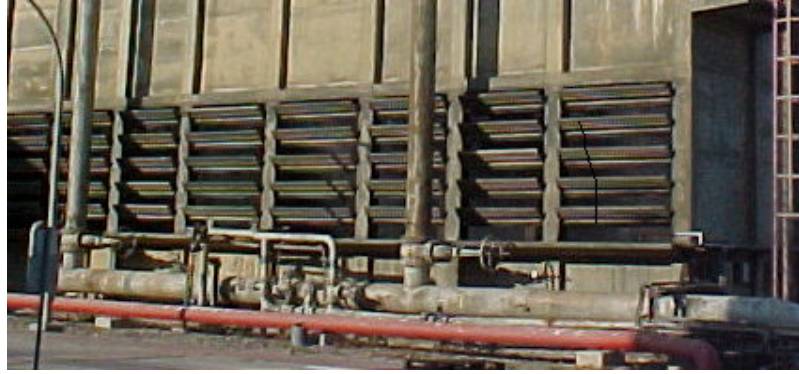
Deflectores de aire de una torre de refrigeración.
