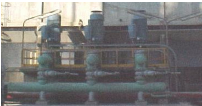
Bombas de una torre de refrigeración.
