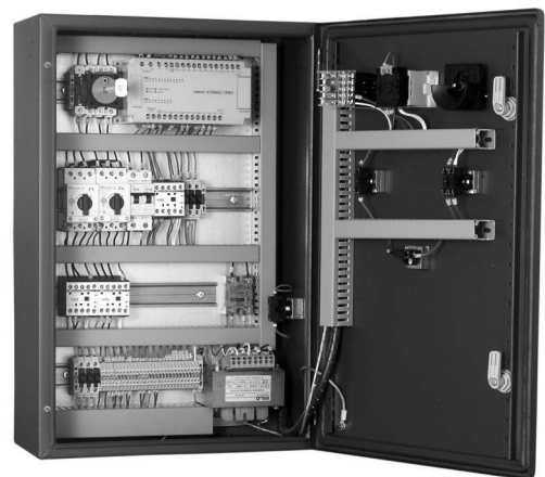
Figura 3.42: Cuadro almacenado en armario
