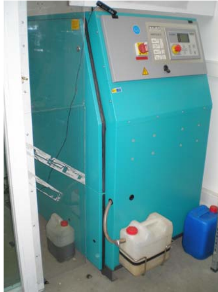
Figura 9: Fotografía del compresor de aire
