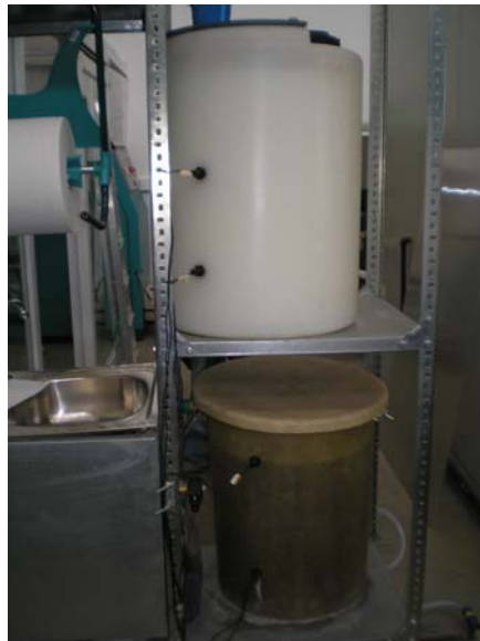
Figura12: Fotografía de los tanques de alimentación
