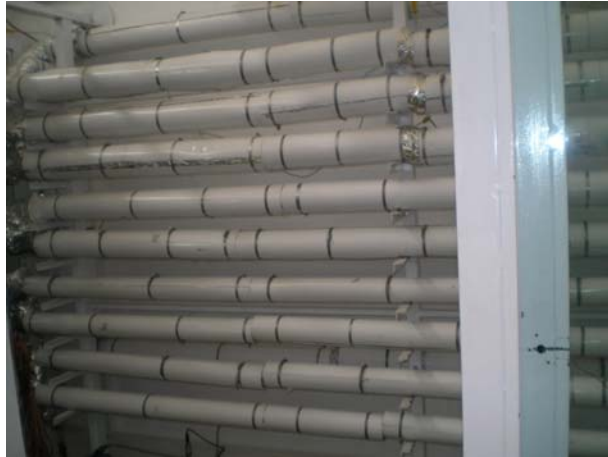
Figura 7: Fotografía tramos de reactor e intercambiador aislados
