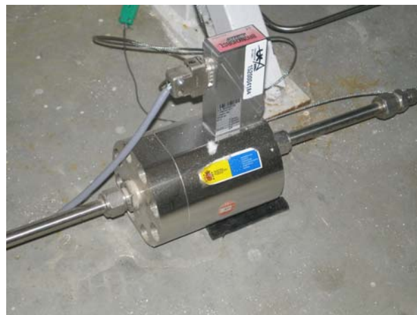
Figura 14: Fotografía del caudalímetro de gases
