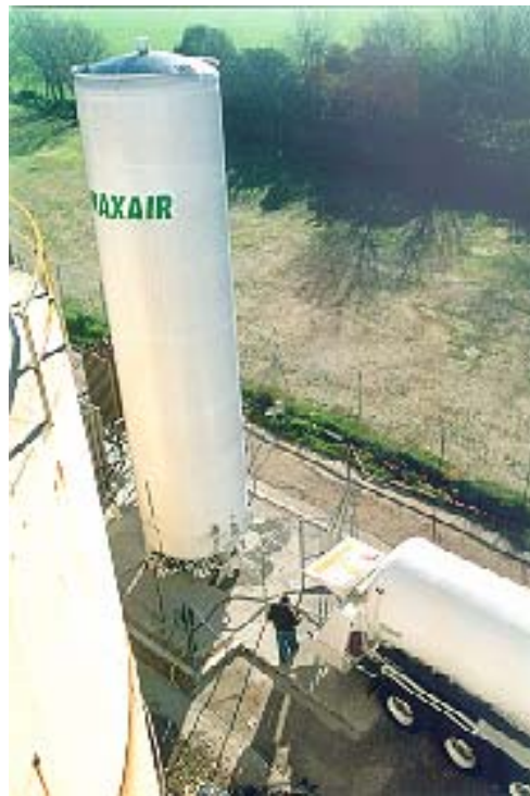
Figura 3.4 Sistema de almacenamiento de oxígeno puro
