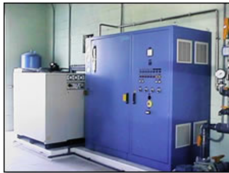
Figura 4.2 Generador de ozono
