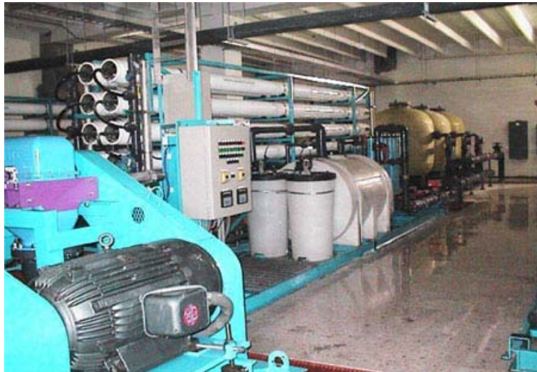
FIGURA 4.5 : RACK DE ÓSMOSIS INVERSA.
