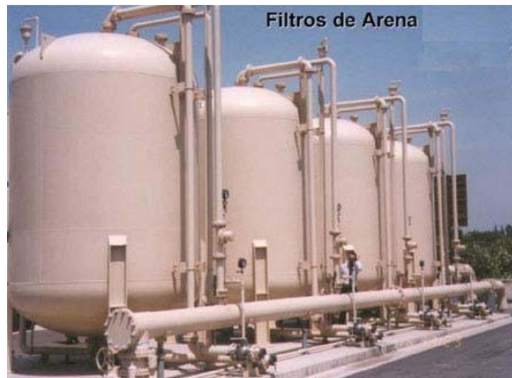
FIGURA 4.2 : FILTROS DE ARENA.
