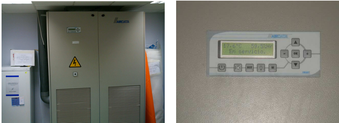
Imágenes 5 y 6 Armario de control de las condiciones de la sala limpia
