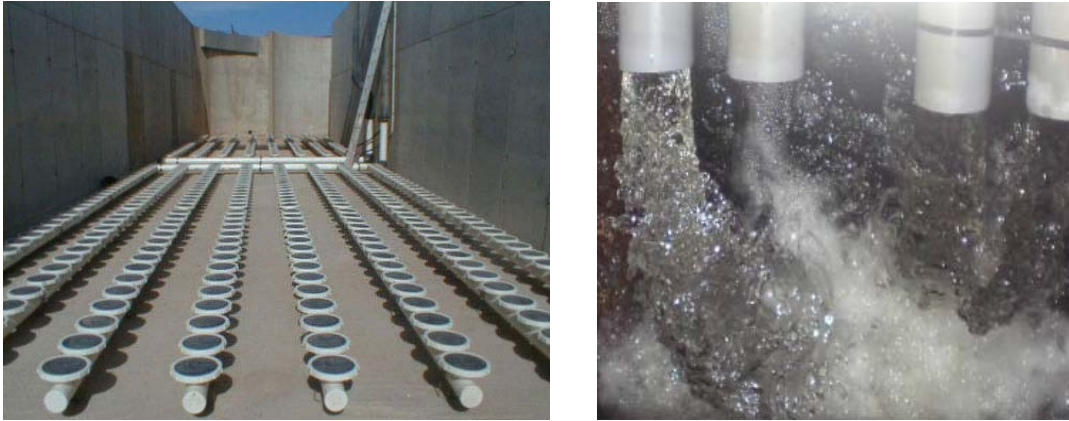
Fig. 6.15. Detalle de difusores de burbuja gruesa de un BRM (Bodegas Jaume Serra , Vilanova i la Geltrú, (Barcelona) )
