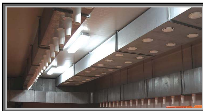
Figura 13. Detalle de las entradas y salidas de aire en la cámara.
