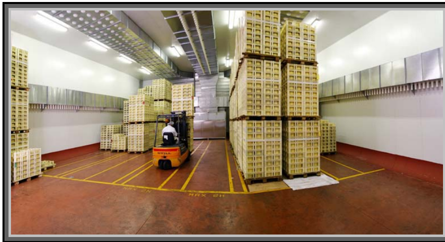
Figura 12. Cámara con sistema de distribución de aire mediante conductos de difusión con conos de impulsión y bocas de aspiración en el techo.
