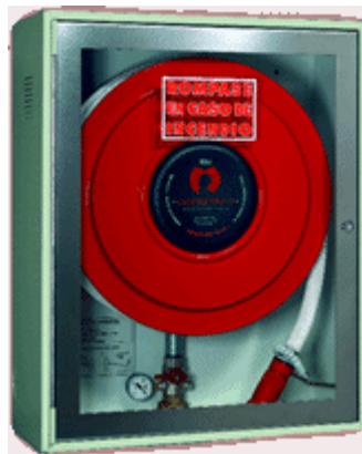
Boca de Incendio Equipada
