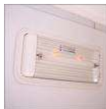
Alumbrado de emergencia
