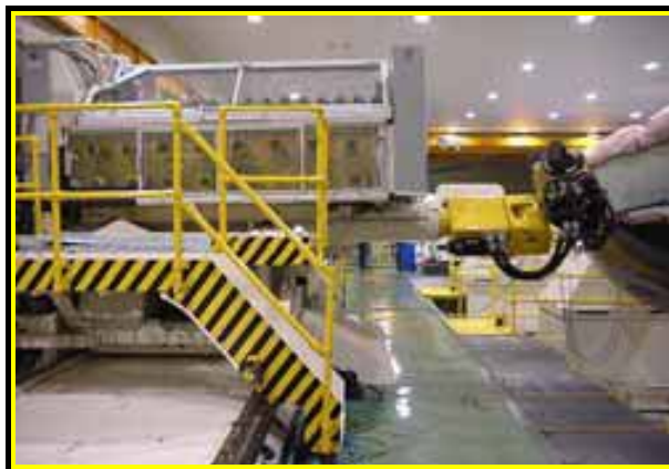
IMAGEN 340. Detalle de zona de paso en laminado
