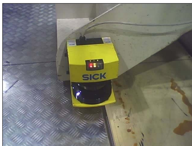
IMAGEN 348. Detalle de Escáner laser de seguridad instalado
