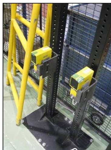
IMÁGENES 346 y 347. Detalle de Cortina Óptica instalada
