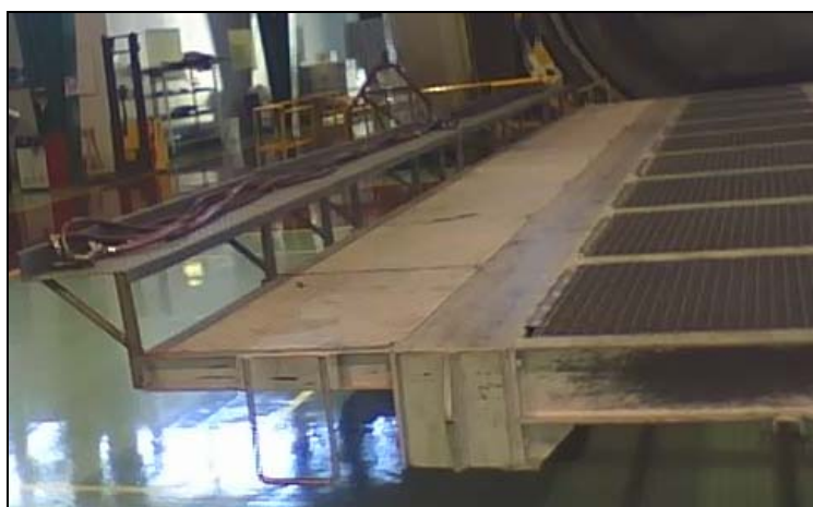
IMAGEN 330. Plataforma de Carga Actual del Autoclave
