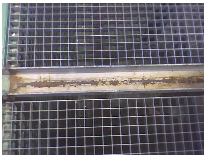
IMAGEN 343. Detalle de carriles para la colocación de útiles
