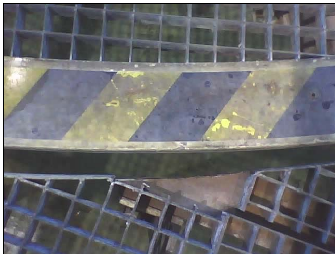
IMAGEN 342. Detalle de separación de plataforma giratoria
