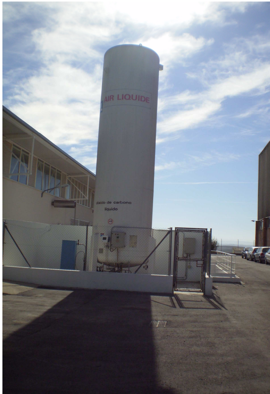
Figura n° 3.8. ( Tanque de almacenamiento de CO 2 )
