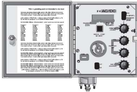
Controlador automático de retrolavado.
