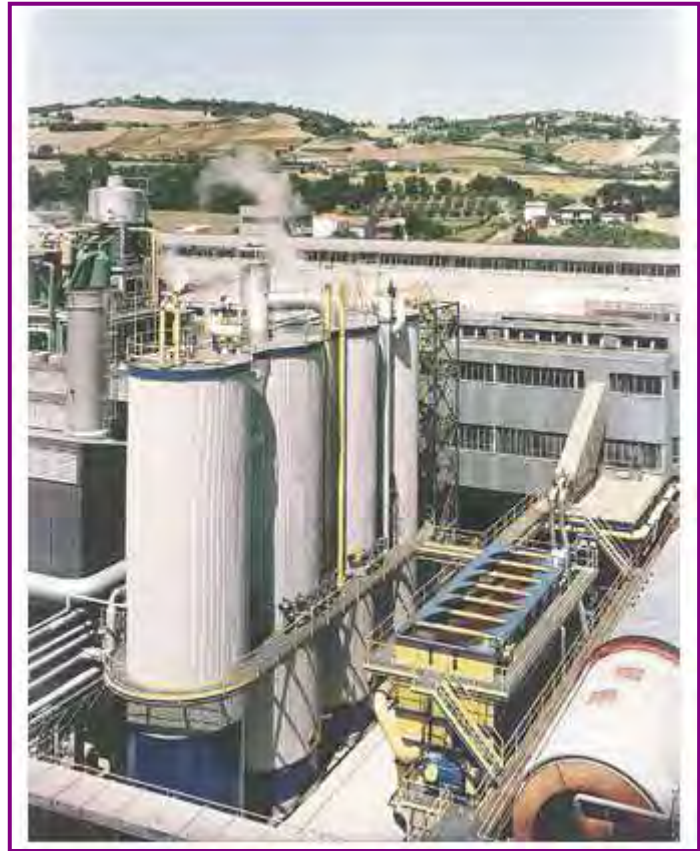
Figura 13.3.2. Torres de carbonatación planta de producción de azúcar en Turquía.
