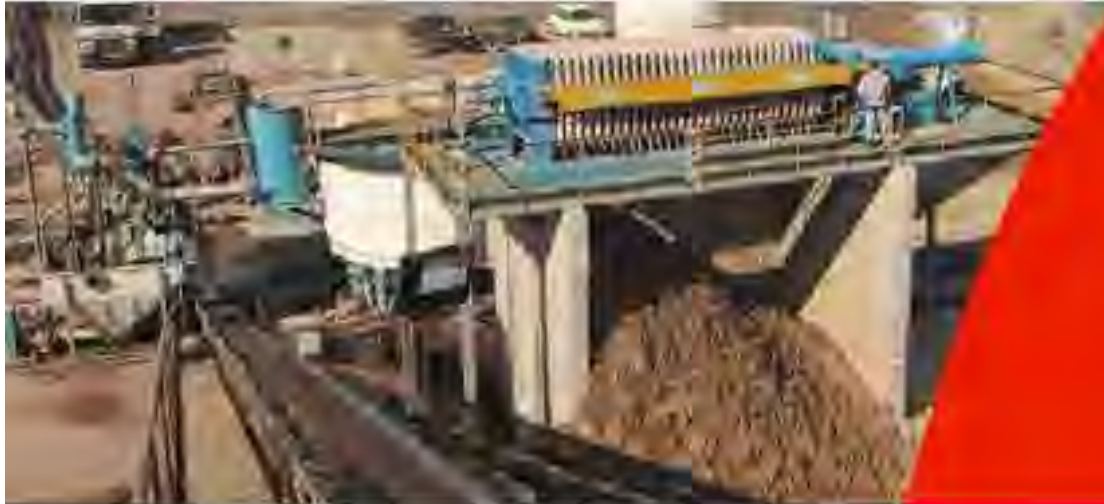
Plantamiento integral de efluentes
