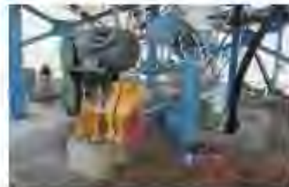
Sistema de descarga a lodos bajo tanque
