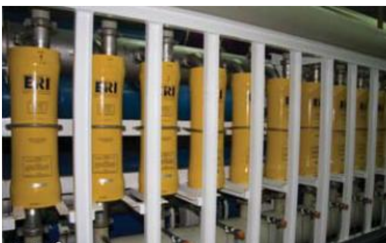
Figura 10.5-g: Intercambiadores de Presión ERI en una IDAM.
