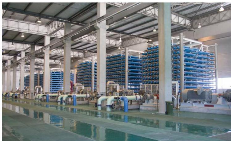
Figura 10.4-a: Bastidor de Ósmosis Inversa IDAM Telde.
