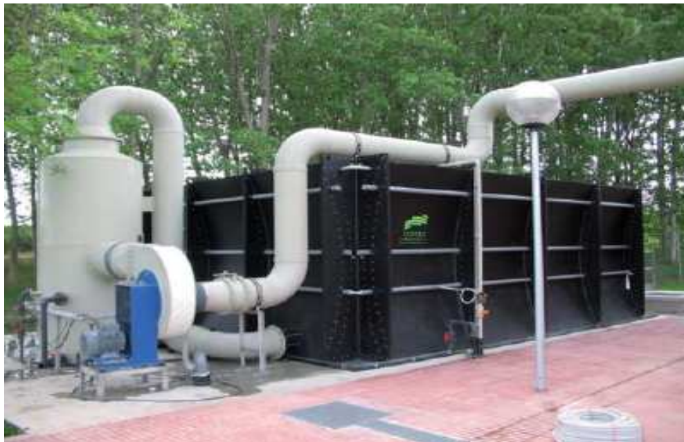
Figura 7: Biofiltro de tanque contenedor metálico.
