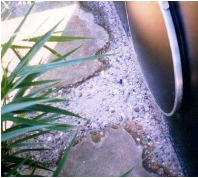
Solera de hormigón sin protección atacada por lixiviados procedentes de un biofiltro
