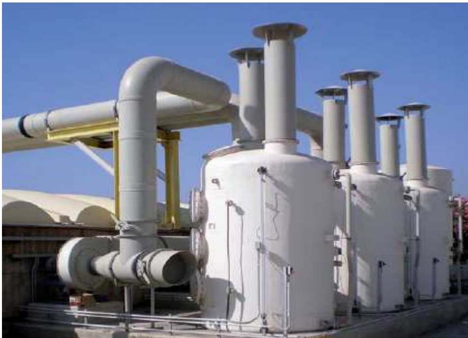
Figura 5: Torres de desodorización de carbón activo.
