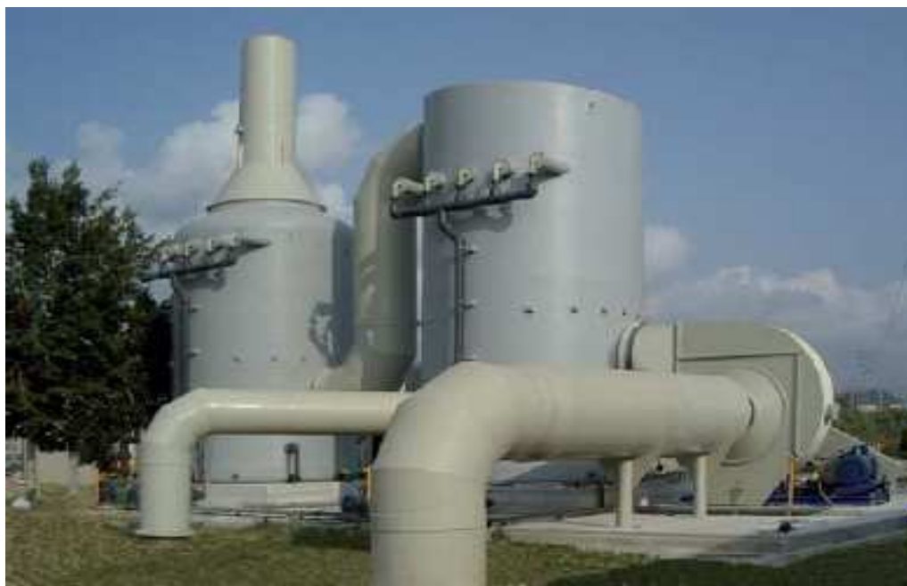
Figura 8: Torres de lavado químico.
