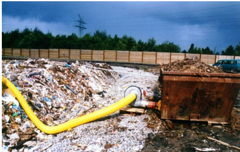
Biofiltro realizado en el interior de un contenedor de acero. Se aprecia el comienzo de la corrosión.
