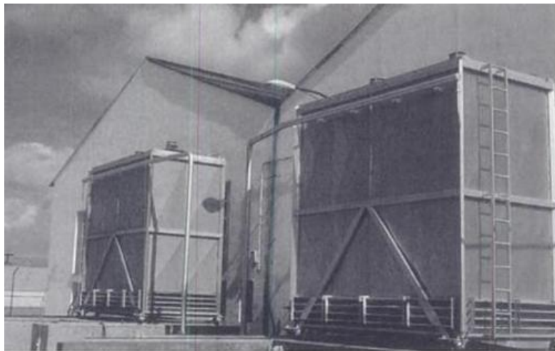
Figura.3.20.Vista exterior de una torre de refrigeración de agua
