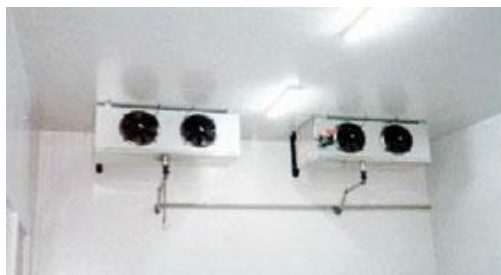
Figura.3.14. Evaporadores de aire de convección forzada
