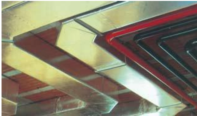
Ilustración 15. Conductos de aire.
